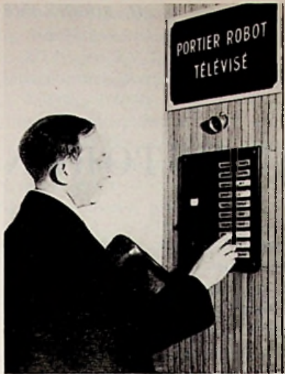
Keuzepaneel en camera in de hal o, trappenhuis.
